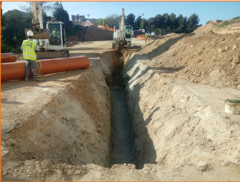
Foto 7. Seguiment del rebaix de la unió entre els dos trams de rasa, un cop enderrocada la casa.
